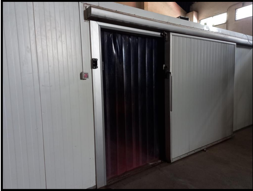
Cámara de Almacenamiento
